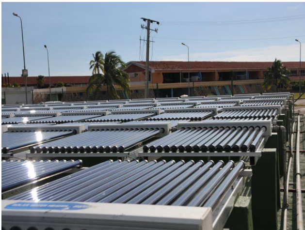
Die größte Solarthermische Anlage Kubas im Hotel „Rancha Luna“, Cienfuegos (Quelle: 5 de Septiembre )
