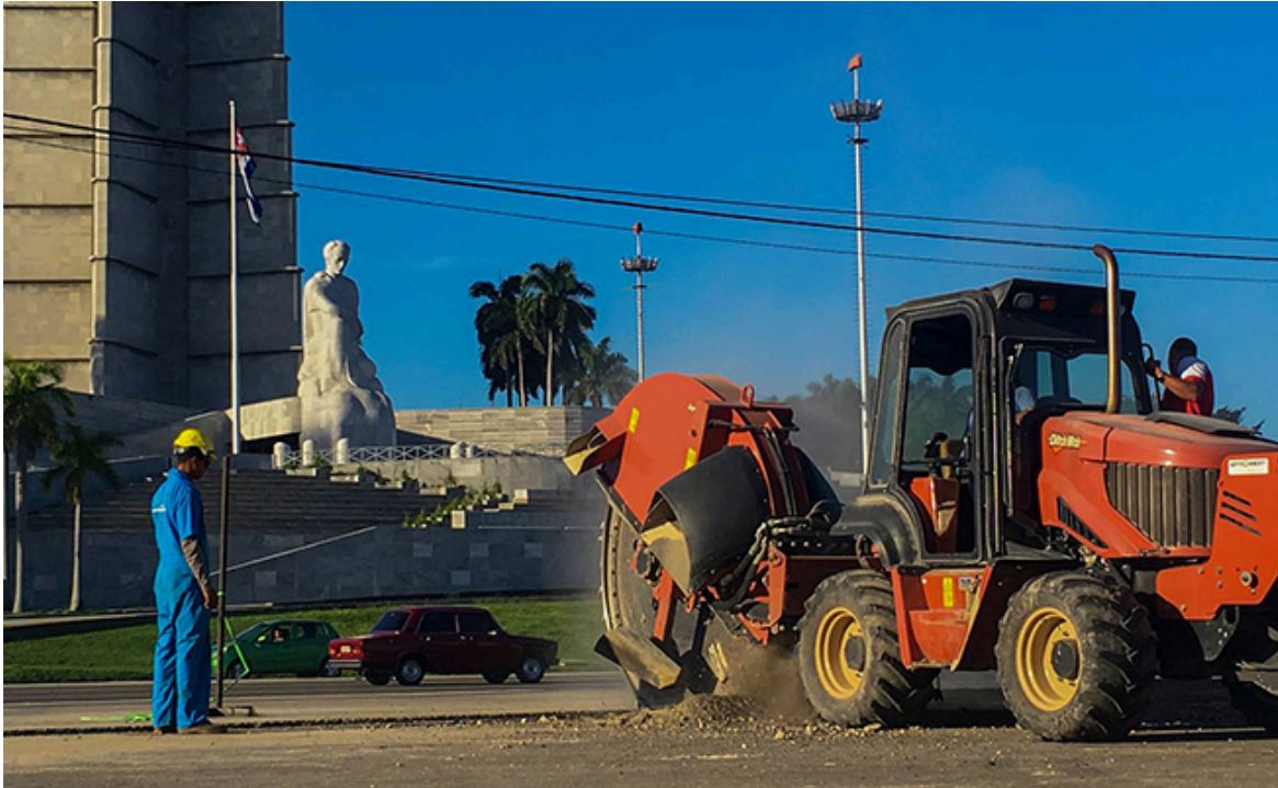
Im Bau: Der Revolutionsplatz in Havanna soll bald in neuem Licht erstrahlen (Quelle: Cubadebate )
