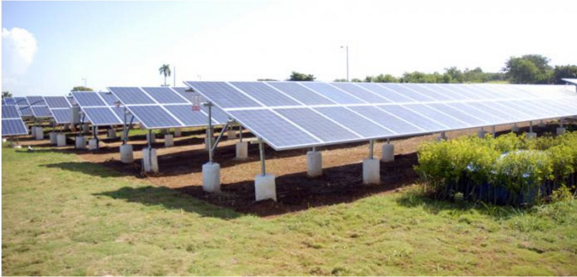
Havannas erster Solarpark auf dem Gelände von Expocuba (Quelle: Granma )
